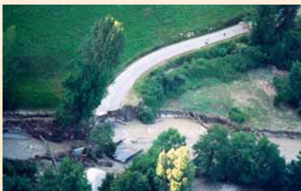
Pont de la RD82k détruit par la crue de l'Ainan 6 juin 2002 © L. Gallin-Martel
