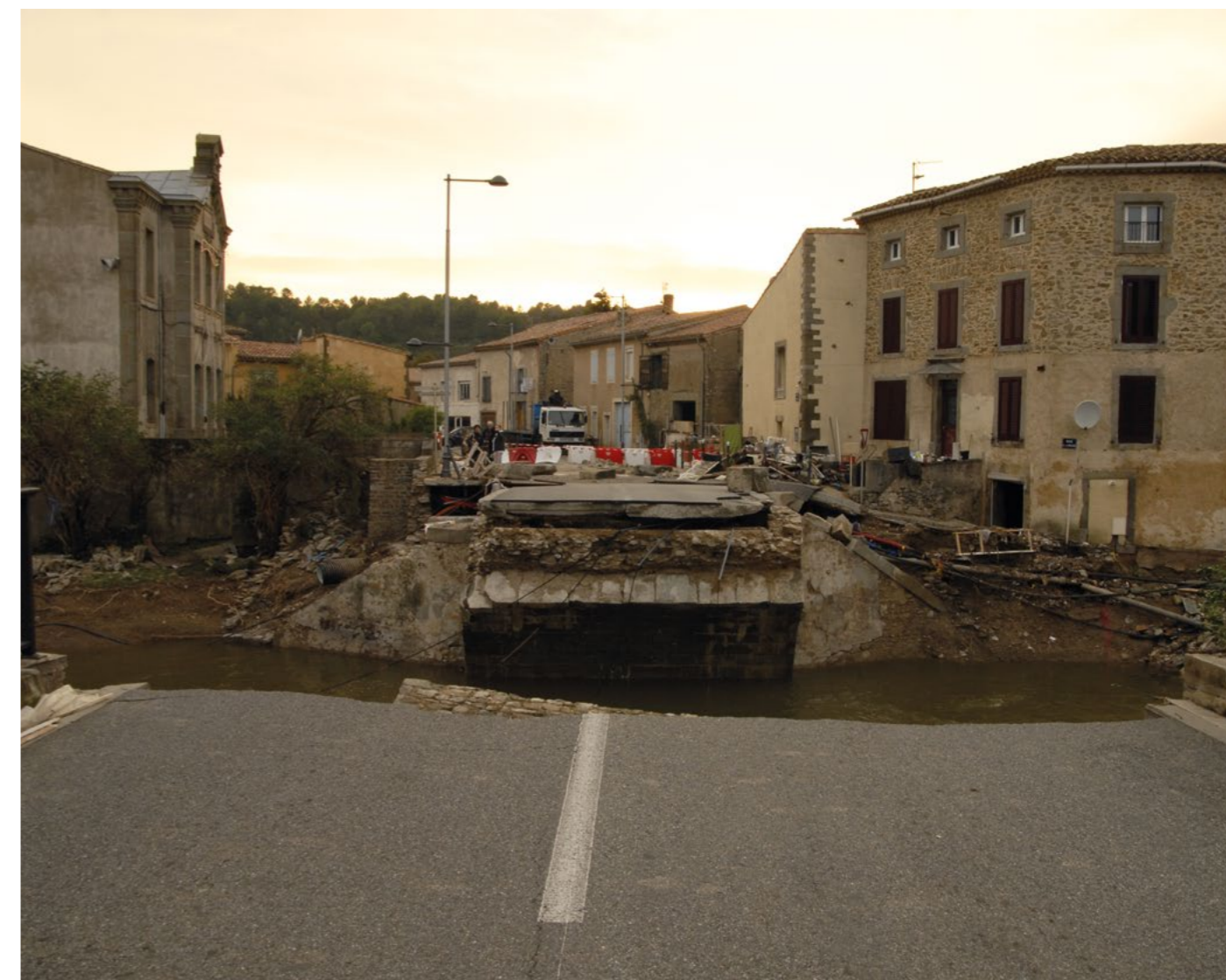
Pont de Villegailhenc détruit - Crues de l'Aude de 2018 © IRMA, Mathias LAVOLÉ, 2018
