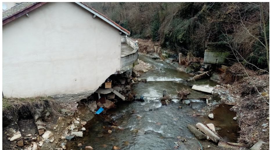
Erosion de la berge du Dorlay - © SEM
